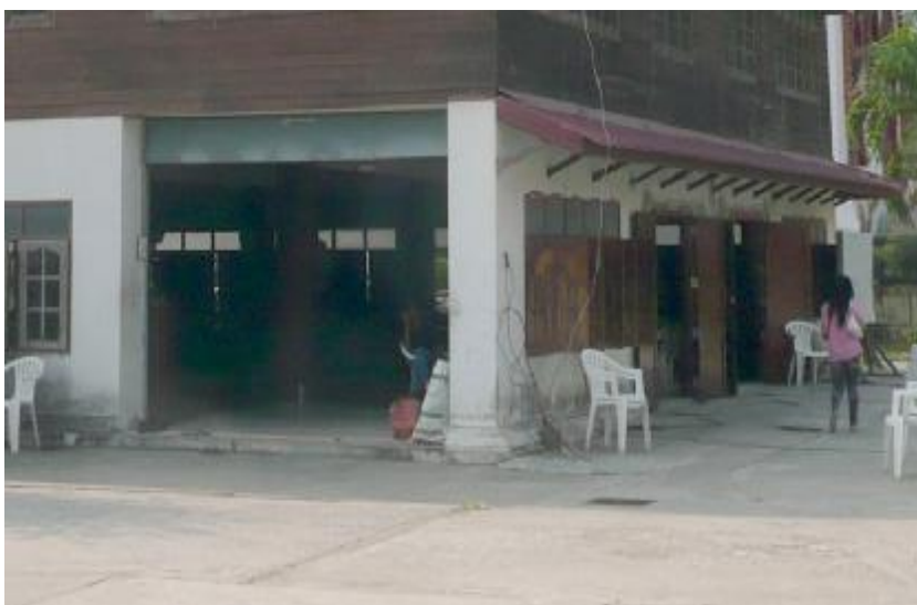
ภาพประกอบ 54 โครงสร้างเสาคอนกรีตที่ต่อเติมเพื่อให้สูงขึ้น
