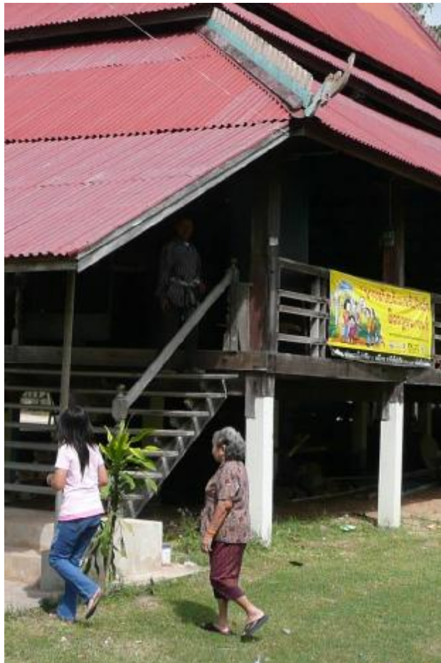
ภาพประกอบ 98 ส่วนที่ชำรุด เช่น ปานลม และลูกกรงบันได
