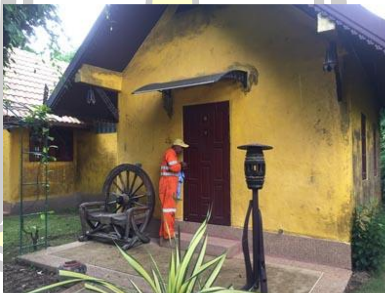
ภาพประกอบ 31 ภาพเชื้อราจากความชื้นขึ้นบนบ้านดิน
